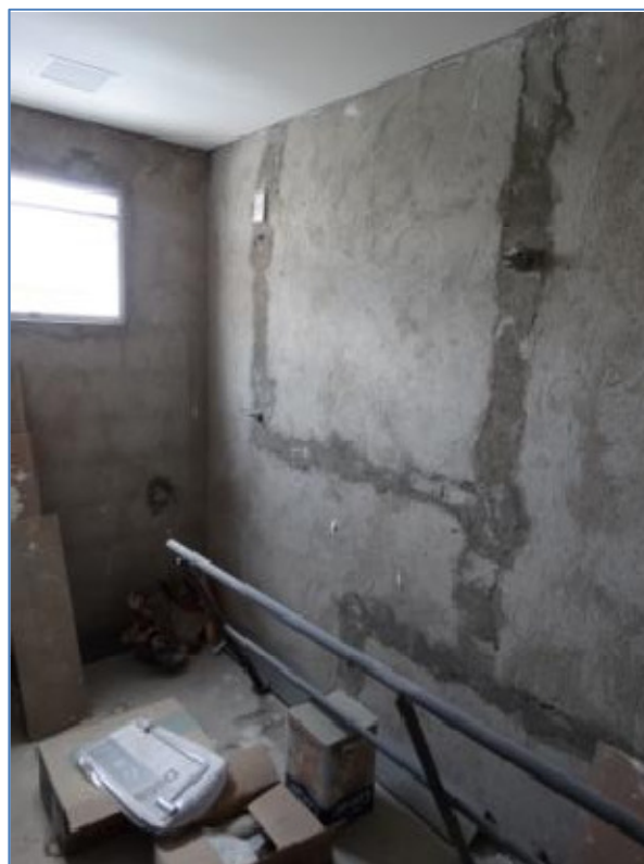
Foto: Casa 2 – 2º pavimento – Banheiro suíte inacabado
